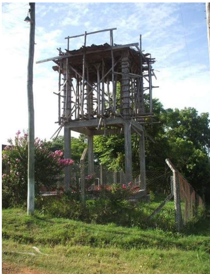
Figura 1 : Foto da estrutura da caixa d'água, que não foi autorizada pelo IPHAN e foi destruída após estar quase pronta. © Foto do autor.
